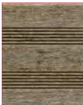
Verwittert nach ca. 1 Jahr im Außenbereich
