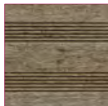
Verwittert nach ca. 1 Jahr im Außenbereich
